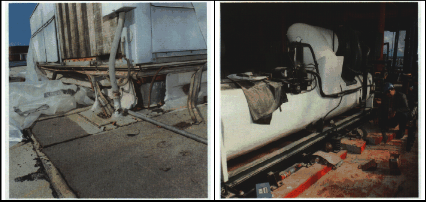
Şekil 5.4 Sağ üstte klima santrali deprem kuvvetleri etkisinde kalarak yerinden oynamış, solda ise ısı değiştirici tedbir alındığı için yerinde duruyor fakat bağlı olduğu beton temel parçalanmış.
